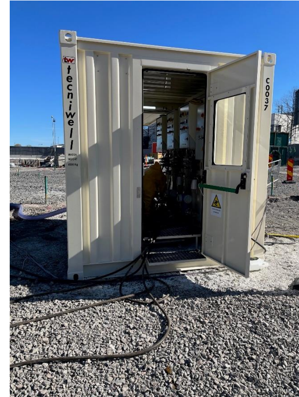
Automatiserad pumpanläggning så att flera punkter kan injekteras samtidigt
