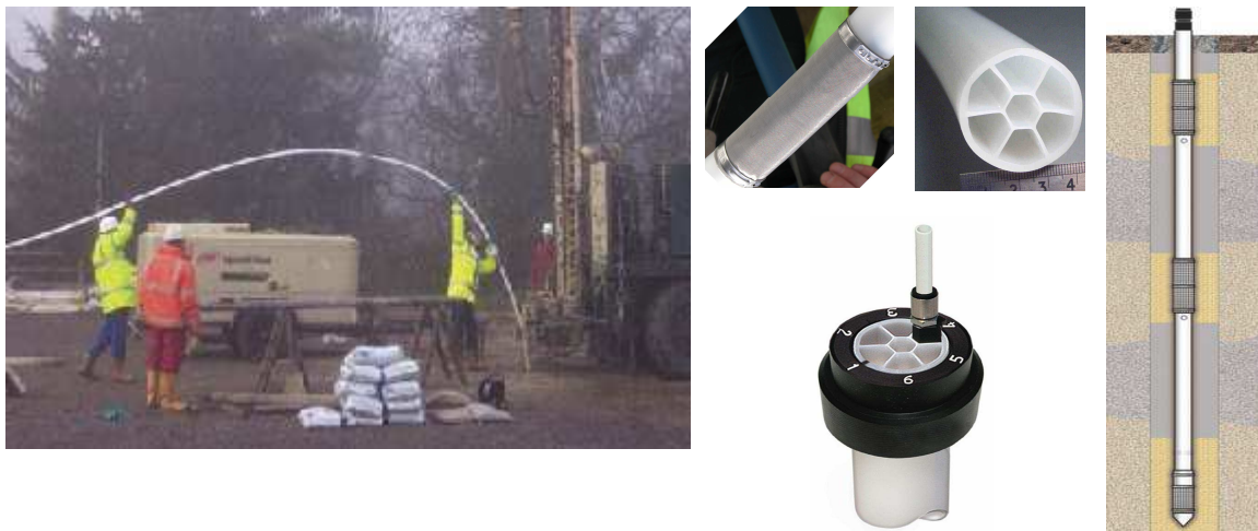
Figur 13. Till vänster installation av CMT-rör [1] och till höger bild på filter, 7-kanals rör, rörhuvud med specialventil för gasprovtagning och en schematisk bild på installation i marken [41].
