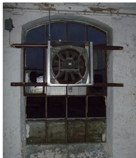
Byggnaden var välventilerad, nästan inga glas kvar i fönstren.
